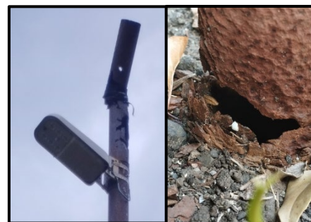
ポールの劣化事例
