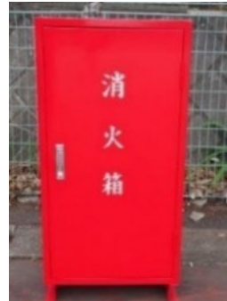
初期消火箱（固定式）
